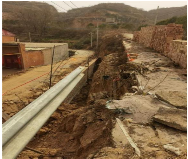
图 3 事故现场照片
