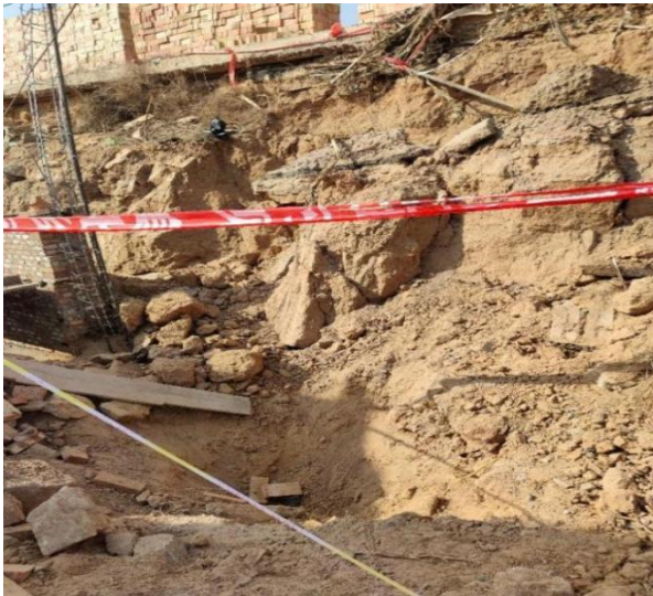
图 2 事故现场照片
